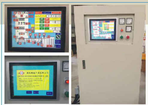
Control panel 控制面板
